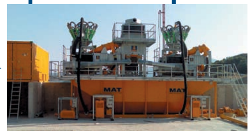
Entsandungsanlage Desanding unit
