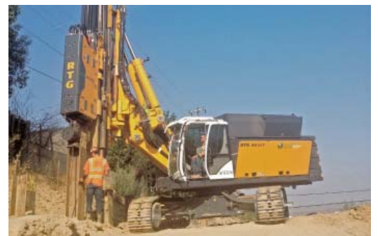
RG 21 T mit MR 150AVM beim Trägerrahmen RG 21 T with MR 150AVM during driving H-beams
